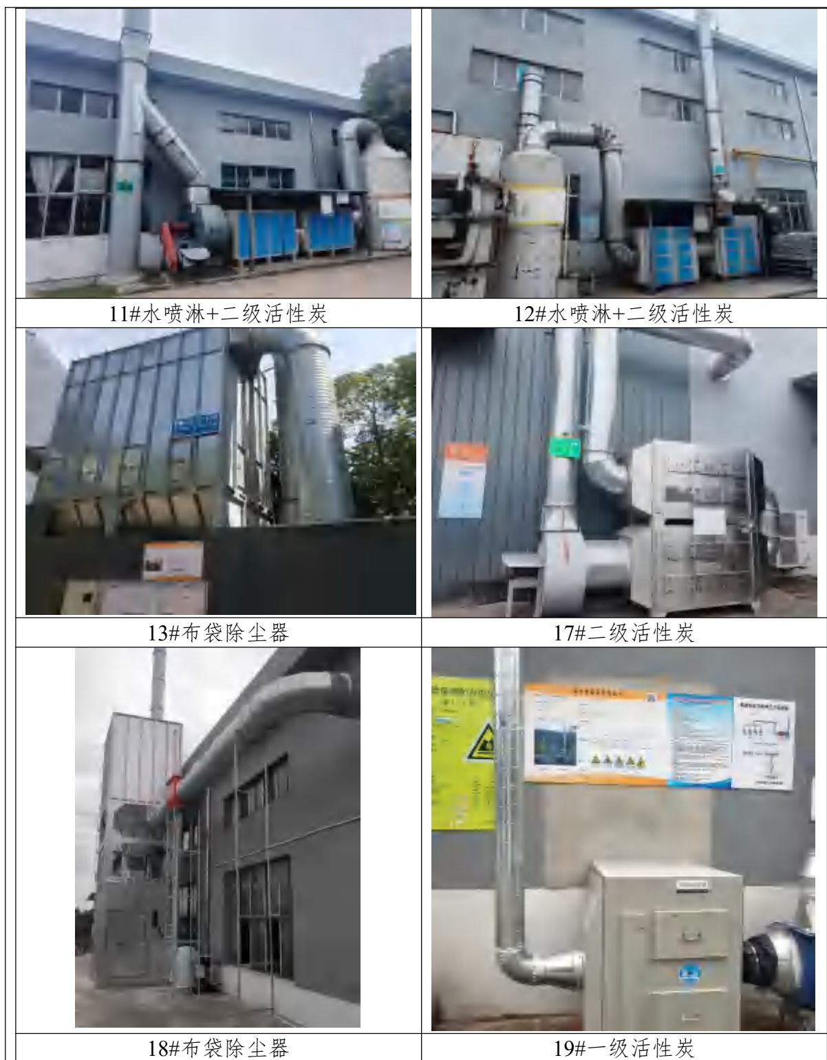
图 3-3 废气处理设施现场照片
